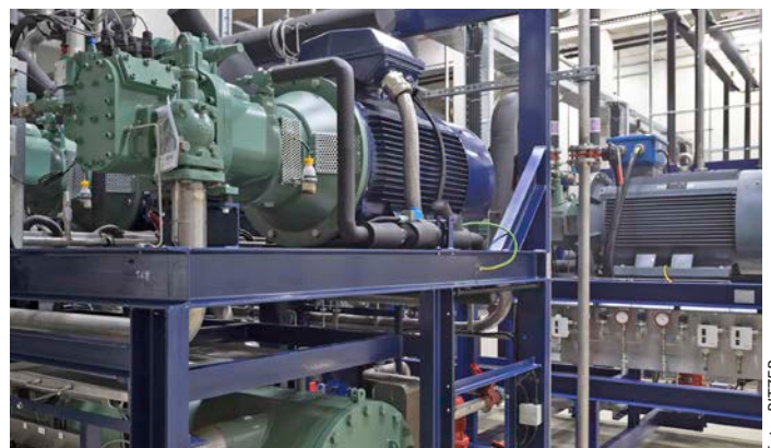
Mehrere Schraubenverdichter von Bitzer bilden das Herzstück der Anlagentechnik.
