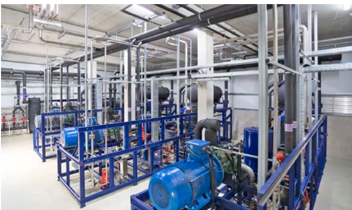
Blick in die Kältezentrale mit den Ammoniakanlagen
